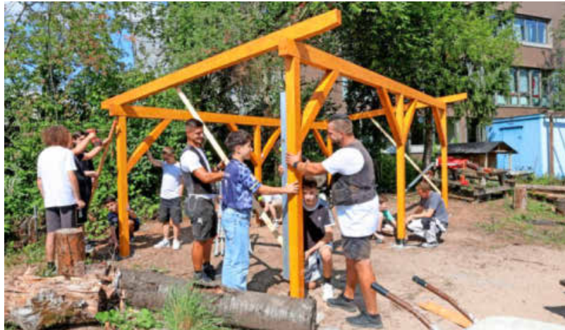
Jugendliche und Handwerker legen ein Freiluft-Klassenzimmer für die Heinrich-von-Kleist-Realschule an. Nächstes Jahr geht es weiter.
