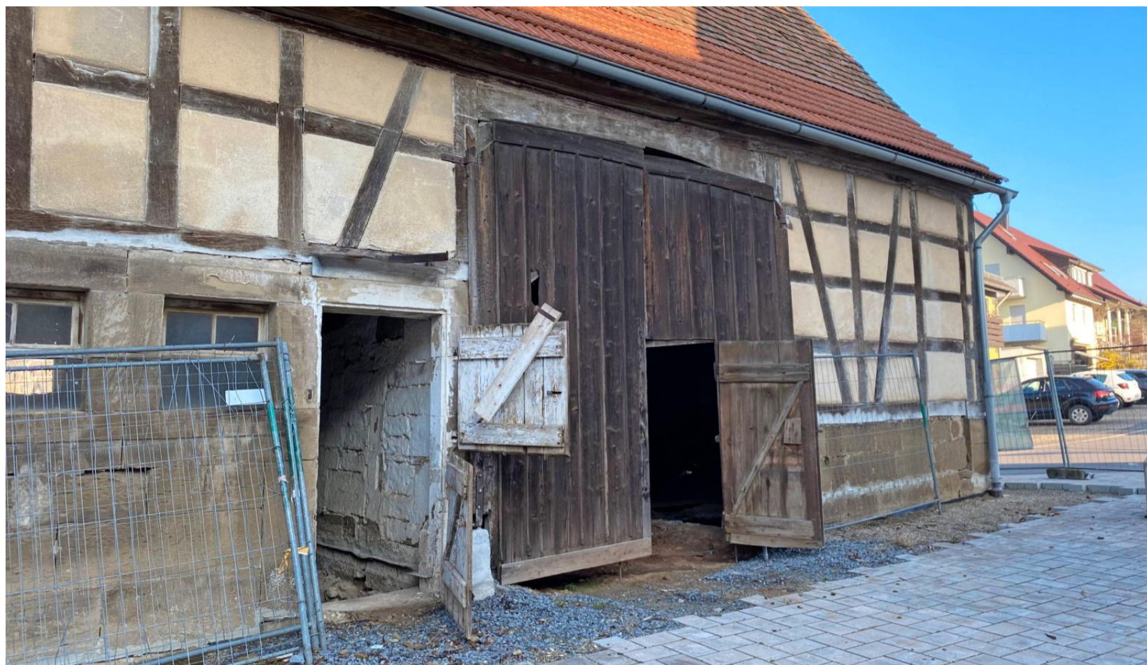
Die Toröffnungen der historischen Scheune in Brettach werden verglast, damit genug Licht in die neuen Wohnungen fällt. Die Tore bleiben erhalten und werden als Sichtschutz rechts und links aufgeklappt. Wo heute eine kleine Tür ist, wird später auch die Haustür sein.
