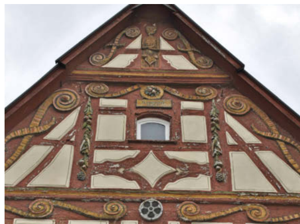
Vor der Sanierung war die Farbe teilweise abgeplatzt, und am Holz gab es viele Schäden. Foto: Schäfer
